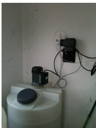
Imagem 4 – Sistema de dosagem de Carbonato de Sódio
