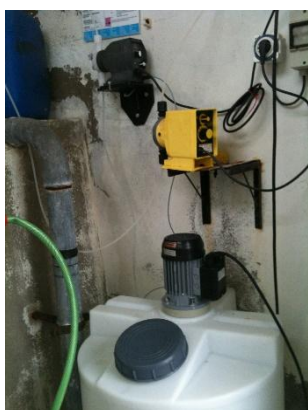
Imagem 2 – Sistema de dosagem de Carbonato de Sódio
