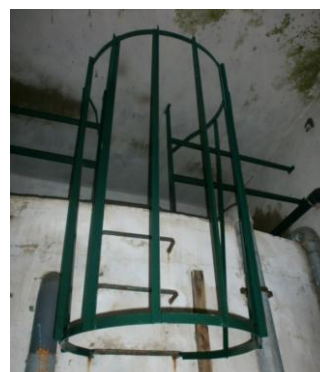
Imagem 7 – Proteção dorsal em escadas
